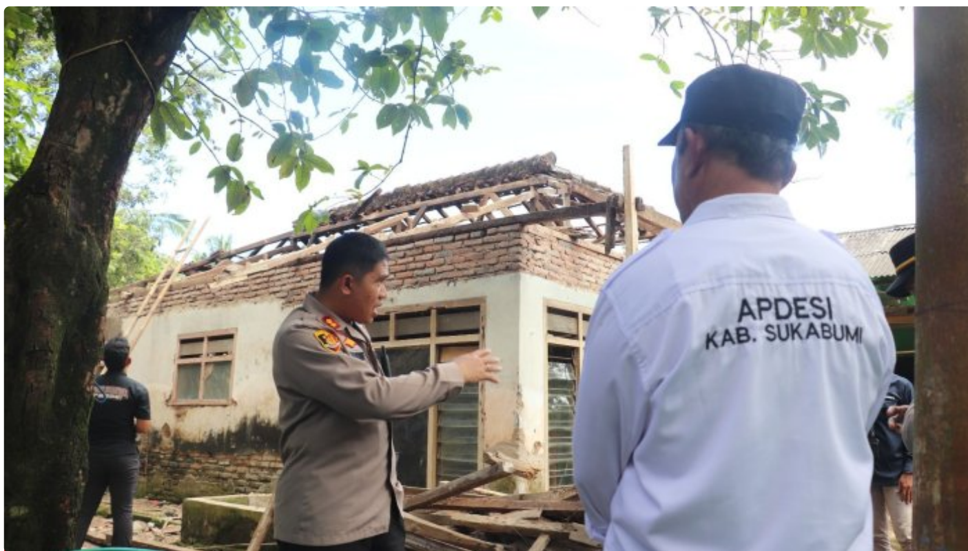
Aa Dede Kembali Renovasi Rumah Warga yang Tidak Layak Huni di Simpenan Sukabumi
